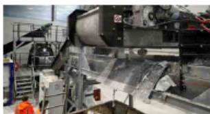
Le déconditionneur imaginé par EcoDDS est installé depuis juillet 2022 sur le site d'Excoffier. Photo DL /Greg YETCHMENIZA
